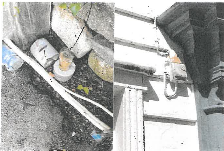
Løs og uryddig kabling.
